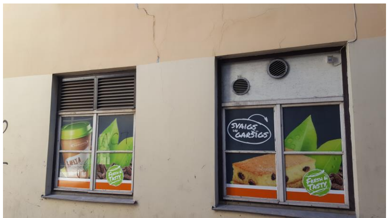
58. attēls. Gaisa ieņemšanas/izvadišanas restes uz fasādes
