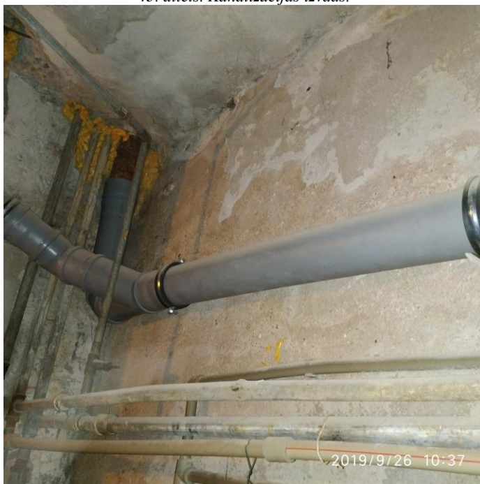
44. attēls. Kanalizācijas tīkls pagrabā.
